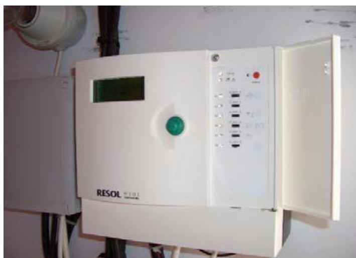
Figura 72. Sistema de regulación y control. Fuente: Belso, 2011.
