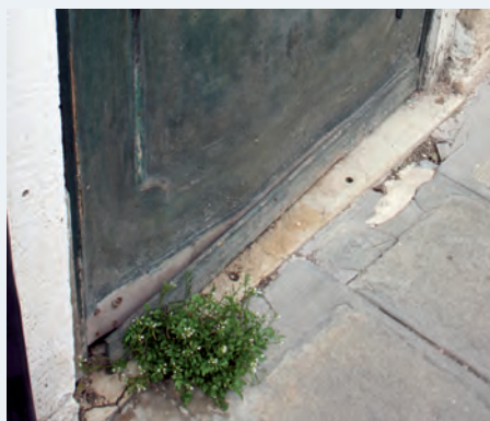
Deformación o alabeo
