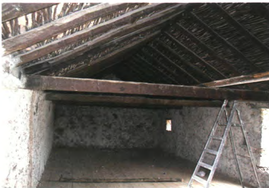
Techumbre a par e hilera de la edificación principal de las casas del obispo en El Carrizal. Posiblemente esta dependencia fuera la destinada a la guarda de los granos y demás frutos obtenidos en la finca.
