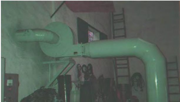
Figura 12.- Ventilador extractor (Foto del autor)
