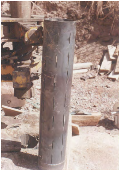
Figura 20.- Tubería ranurada (Foto del autor)
