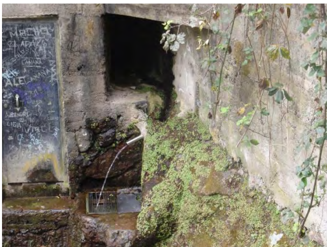
Figura 35.- Naciente acondicionado, Risco Pintado (Barranco de la Mina (Tejeda). (Foto Ricardo Sosa, Vigilante de Aguas y Cauces CIAGC)
